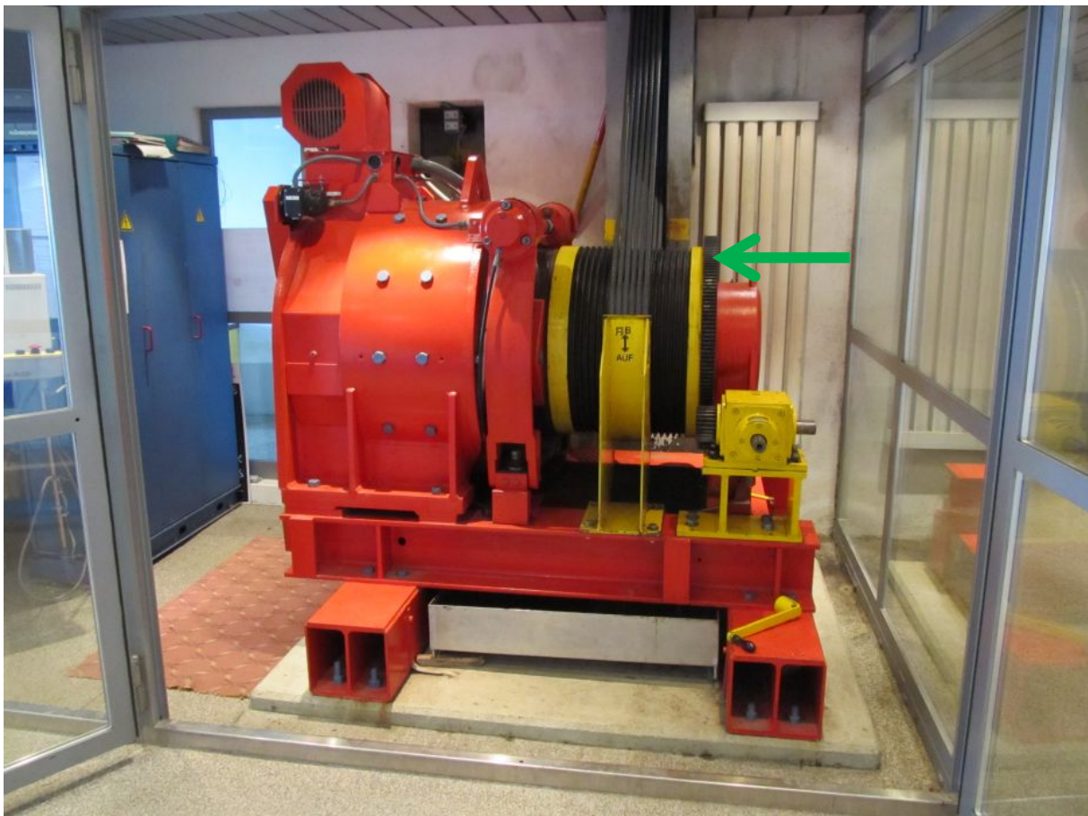
Abb. 7: Der Antriebsmotor des Hammetschwand-Lifts
